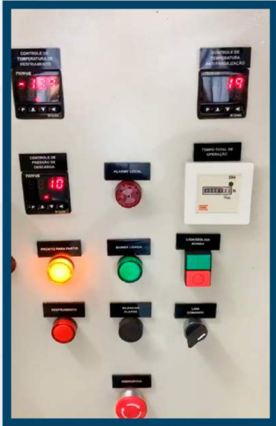
PAINEL DE COMANDO PARA BOMBA DE ENCHIMENTO DE GASES DO AR
