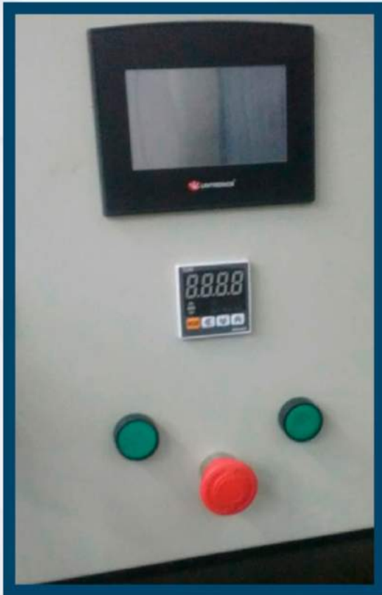
PAINEL DE COMANDO PARA AUTOMAÇÃO DE ESTUFA DE GASES ESPECIAIS
